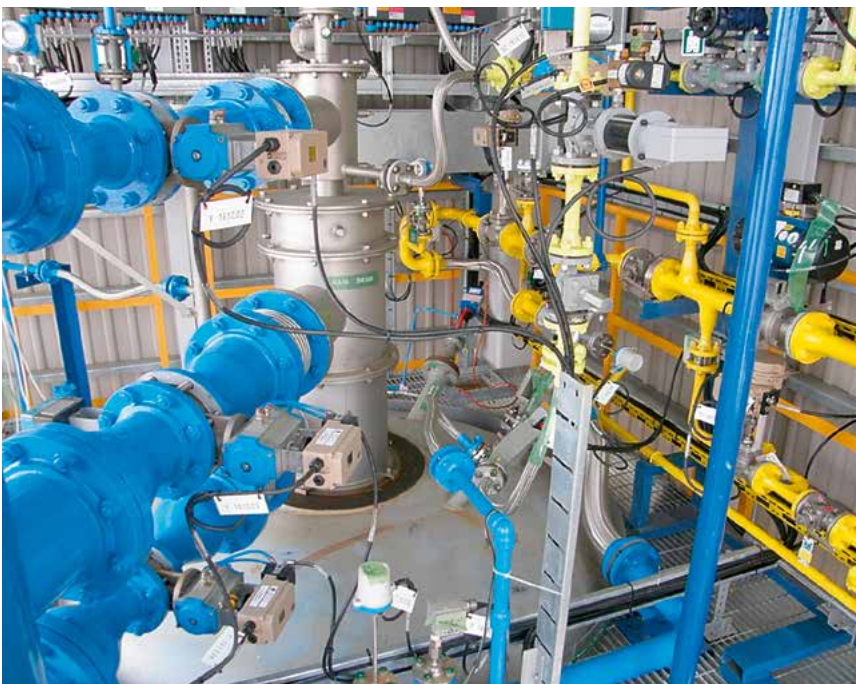
Brennersystem mit Brennstoff- und Abgasstrecke
