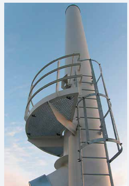
Abgaskamin mit Emissionsmessstation
