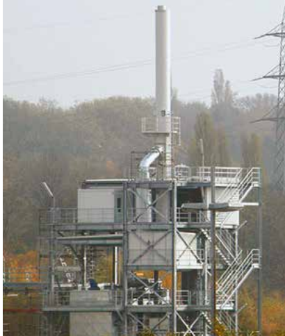
Verbrennungsanlage für silanhaltige Abgase
