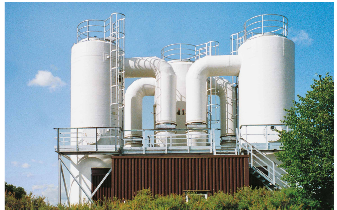
Luftstrippung zur Behandlung von Zentratwasser einer Kläranlage
