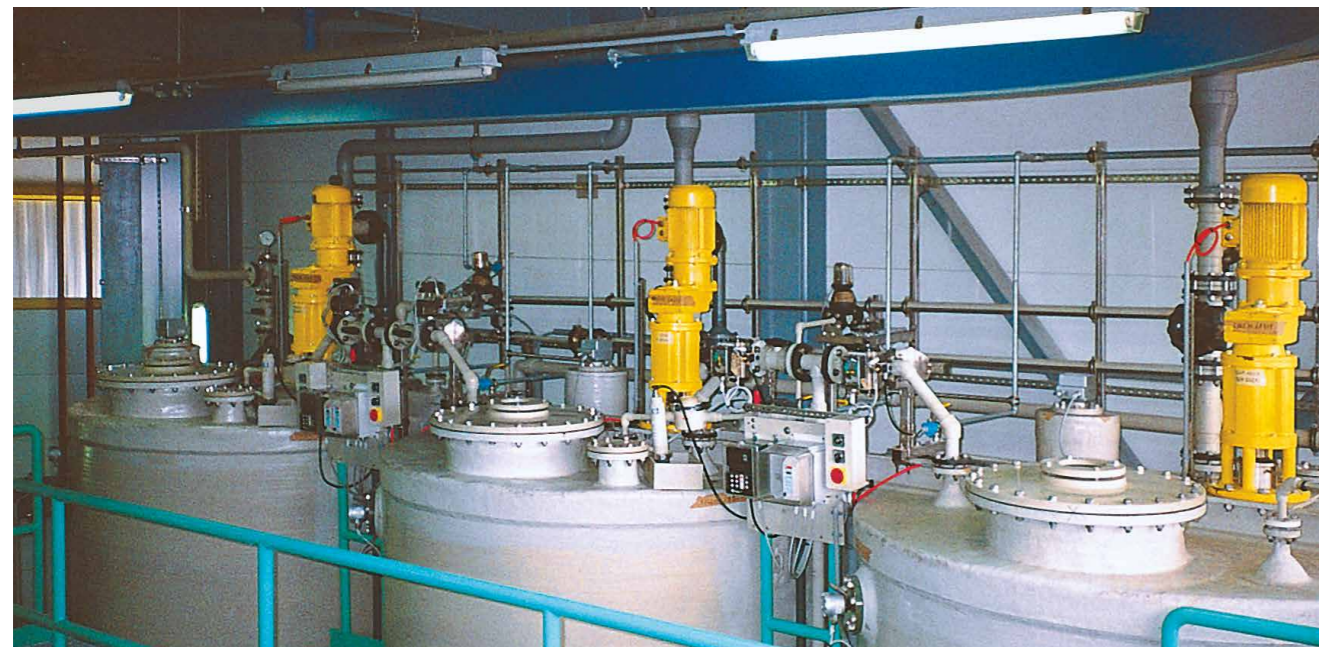
Anlage zur Alkalisierung von Rohwasser mit Kalkmilch
